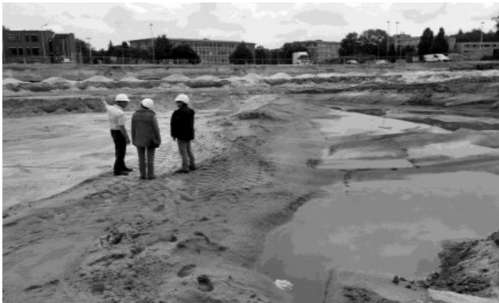
Overzicht over de bouwput gezien in zuidoostelijke richting. In de dam bevindt zich de waterkerende kleilaag. Het grondwater staat rechts meer dan een meter hoger dan links. Op de dam (vlnr) dhr. Spoelstra (Dienst Vastgoed Defensie), mv. Heineman en mv. Kuipers (beiden Bekenstichting). Foto J. Meijer.
